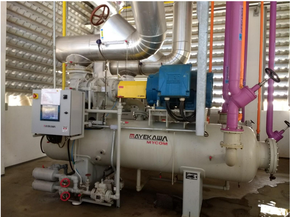
Figura 44 - Compressor Mayekawa 2 e motor Weg 250 cv
