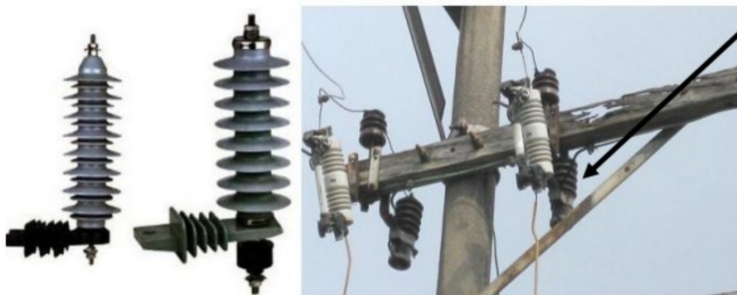
FIGURA 22 – PARA-RAIOS DE LINHAS DE DISTRIBUIÇÃO
