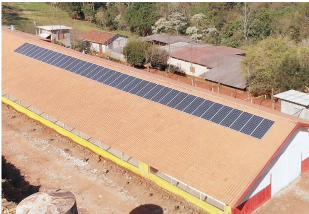
Figura 44 - Ilustra instalação de um sistema solar em aviário.
