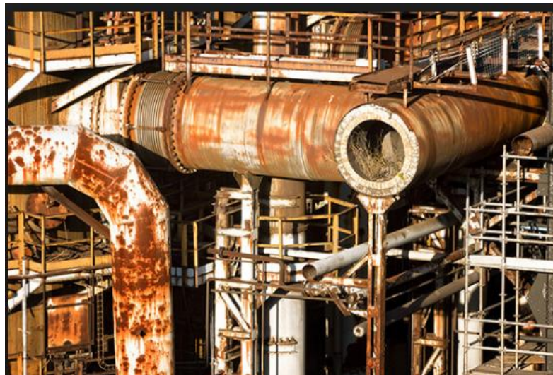
Figura 12 – Corrosão em tubulações de área fabril
