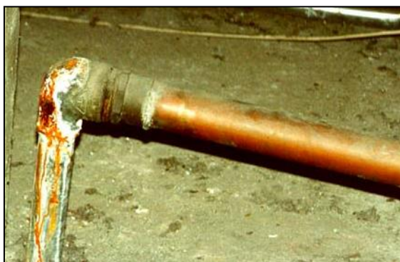
Figura 21 – Corrosão em tubulação de cobre
