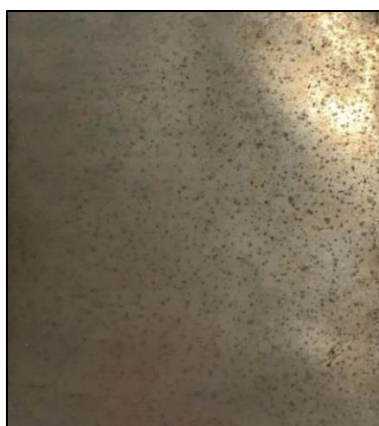
Figura 30 – Corrosão por pites em chapa de alumínio material exposto em Içara – SC -
