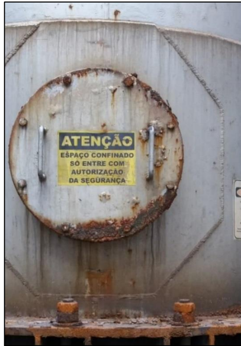
Figura 11 – Corrosão no bocal de visita de um tanque, área fabril Klabin S/A unidade de Correia Pinto - SC
