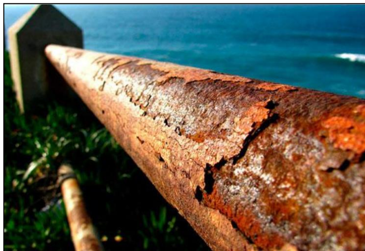
Figura 13 – Corrosão em duto utilizado para transporte de petróleo
