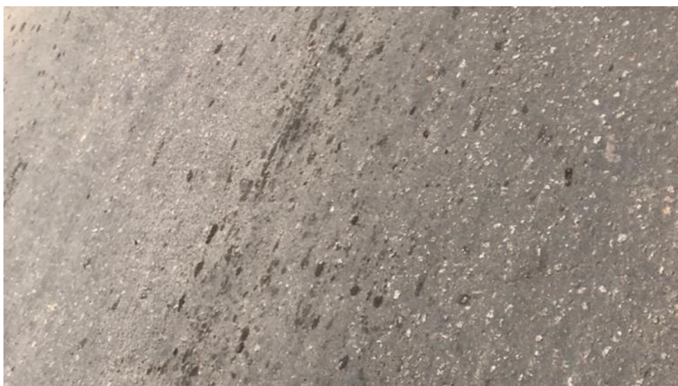
Figura 20- Desgaste no pavimento.
