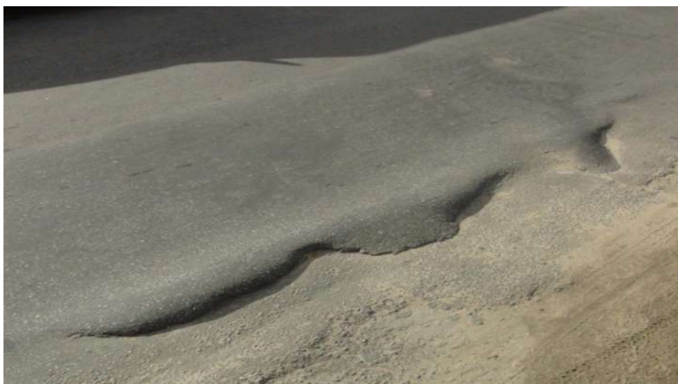
Figura 15- Afundamento do asfalto.
