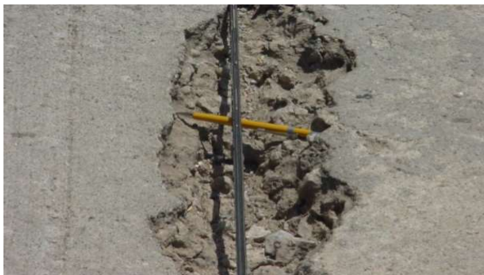
Figura 26- Buracos em pavimento rígido.
