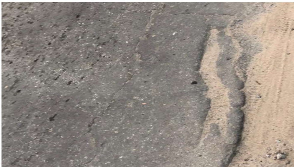
Figura 14- Escorregamentos na via.
