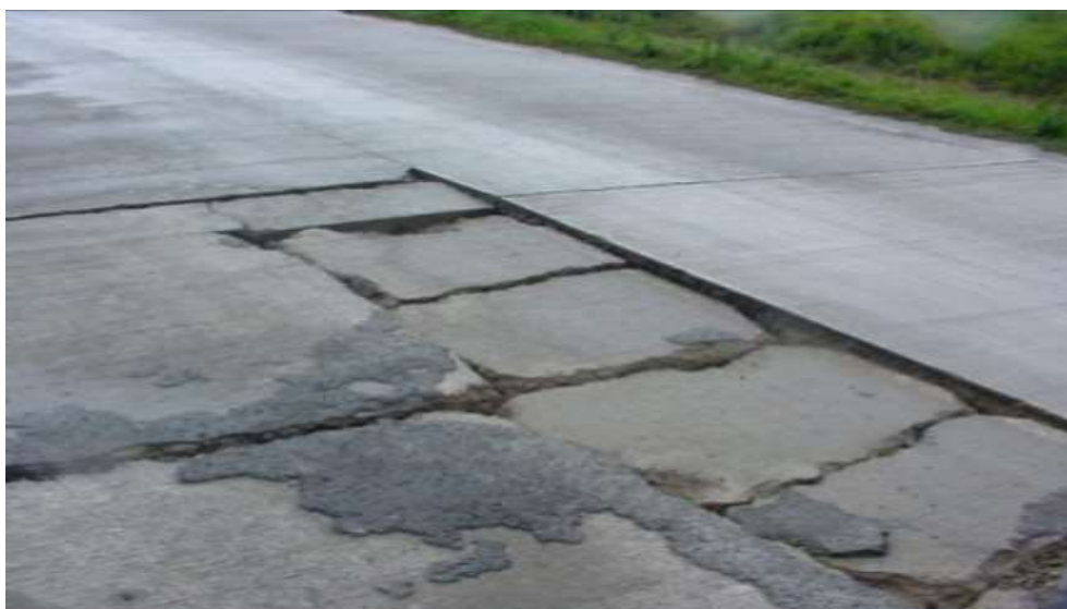
Figura 23- Placa dividida ao longo do pavimento de concreto.
