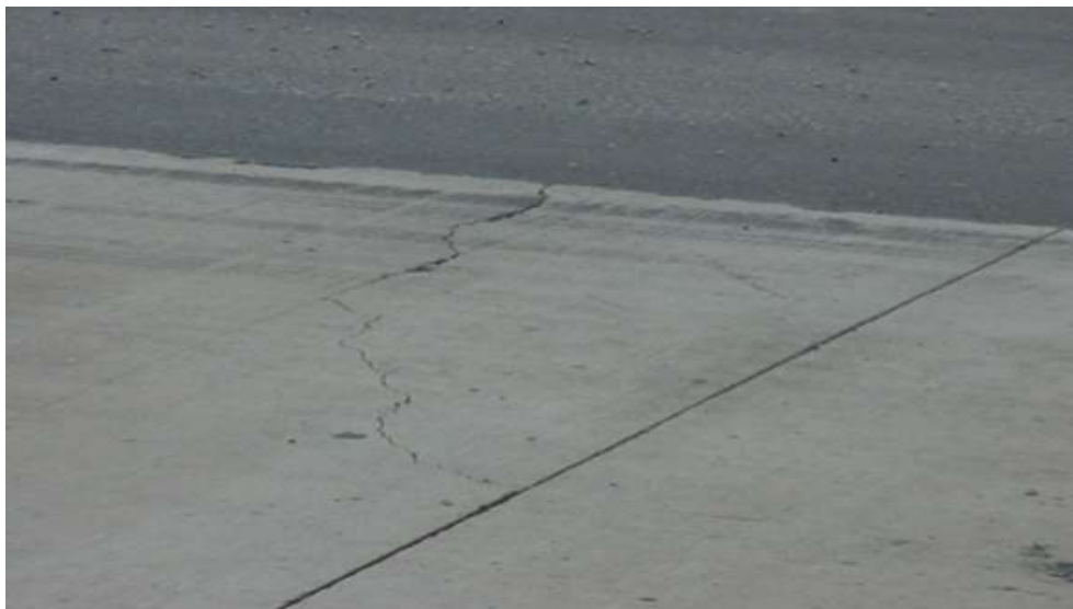
Figura 22- Fissura de canto.
