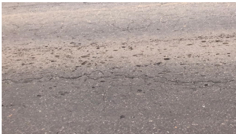
Figura 17- Trincas longitudinais num determinado trecho.
