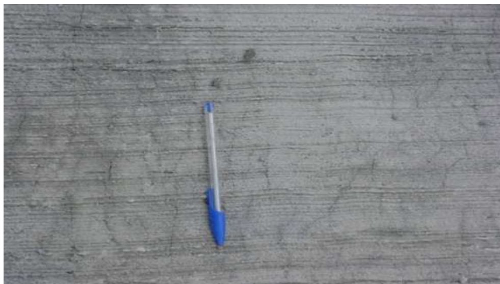
Figura 24- Fissuras de retração plástica.
