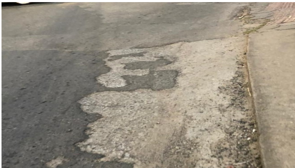
Figura 12- Buraco ao longo da via.
