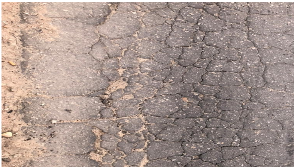
Figura 18- Trinca couro de jacaré.
