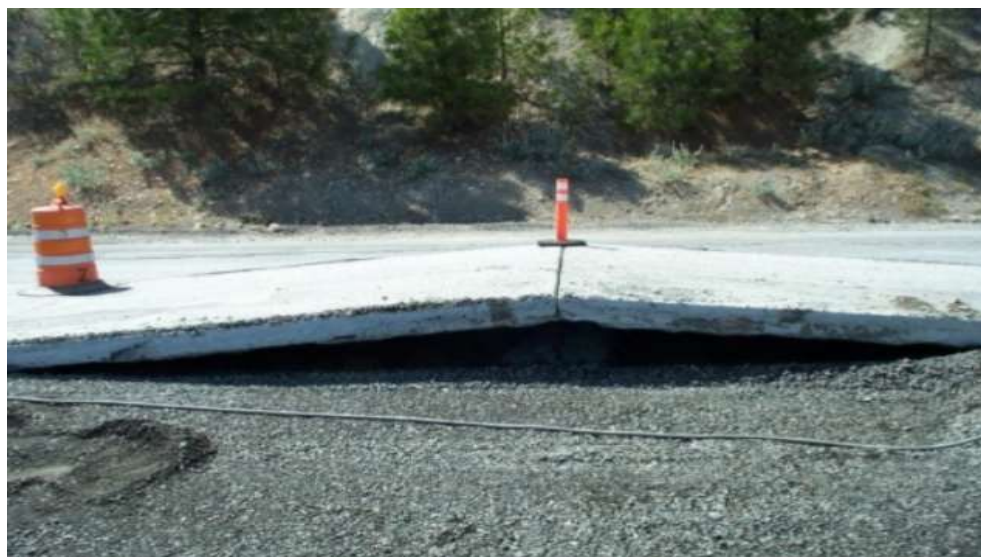
Figura 21- Alçamento de placas no pavimento de concreto.
