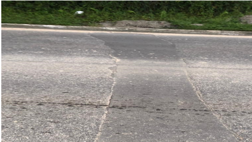
Figura 13- Remendos na via.
