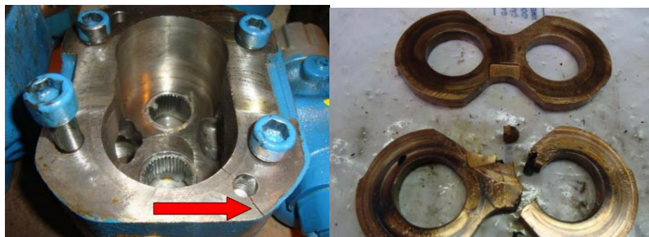
Figura 19 - Quebra dos componentes da bomba devido a sobrepressão.
