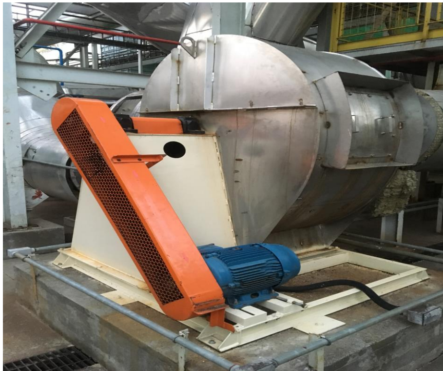
Figura 5 – Ventilador de injeção de ar inferior
