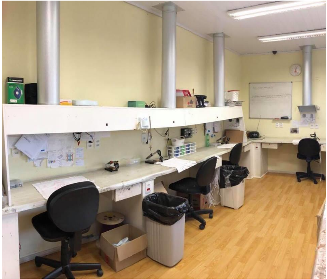
Figura 13: Setor da produção, após a instalação dos exaustores.
