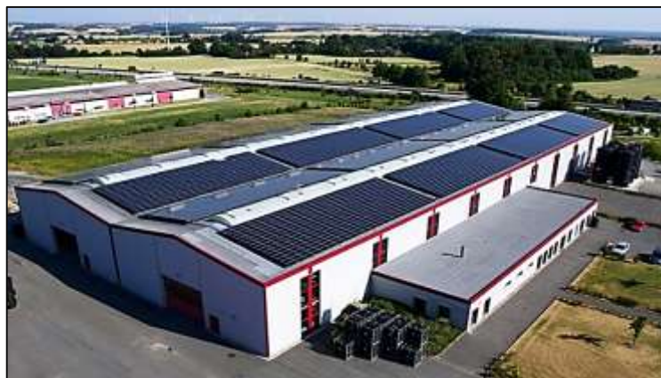
Figura 35 – Sistema de minigeração fotovoltaica em uma empresa.
