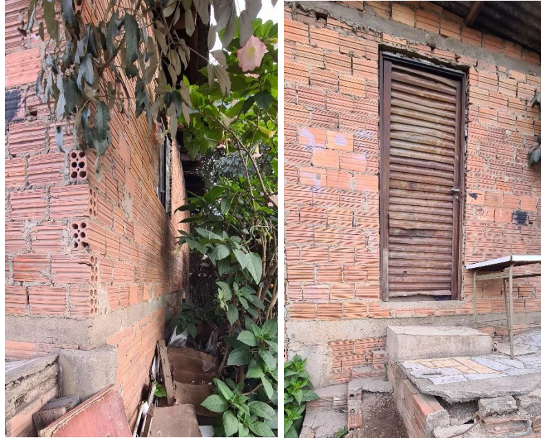
Figura 8 - Ausência de reboco externo nas paredes de alvenaria das moradias
