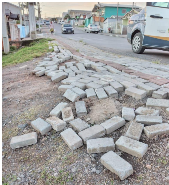
Figura 26 - Calçadas mal executadas
