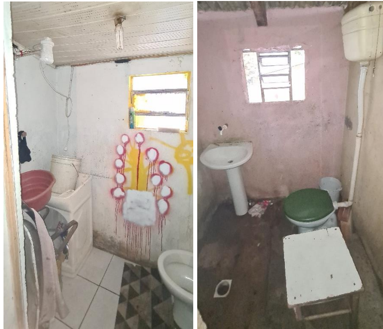
Figura 20 - Banheiros precários de moradias do Loteamento Galha Azul
