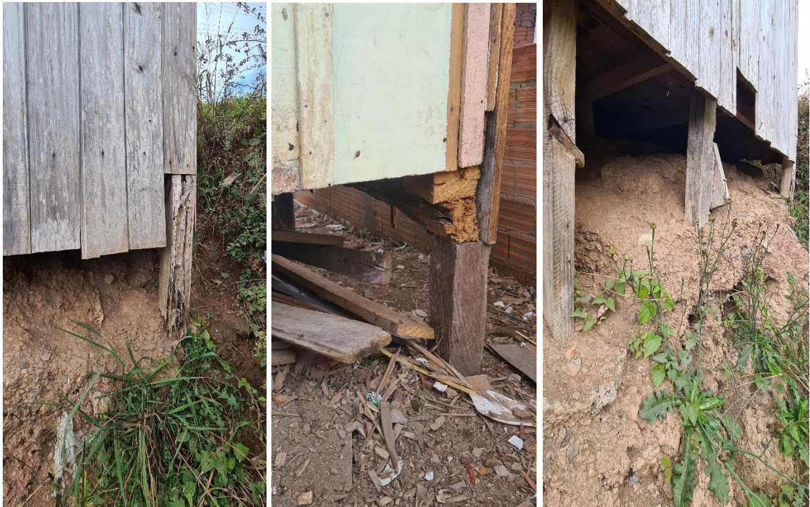
Figura 16 - Estruturas de madeira das moradias com patologias em estado grave
