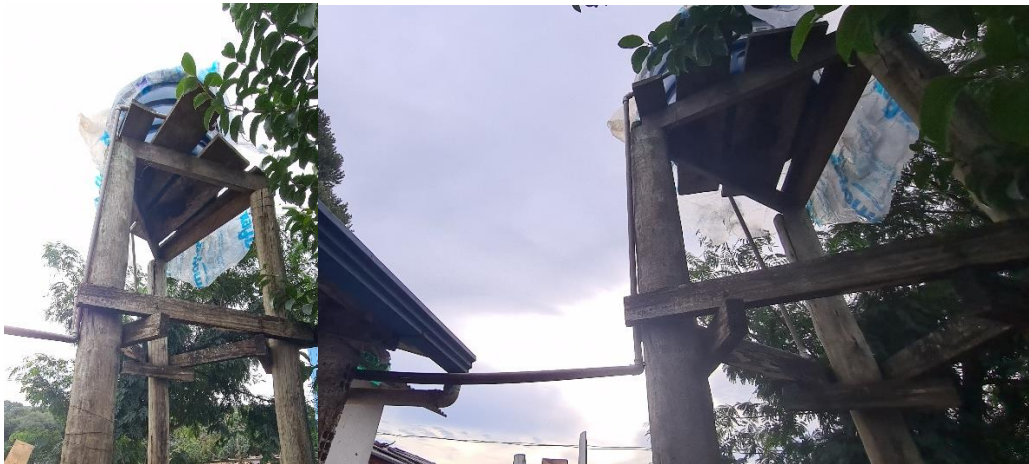
Figura 23 - Caixa da água coberta por plástico sobre estrutura de madeira
