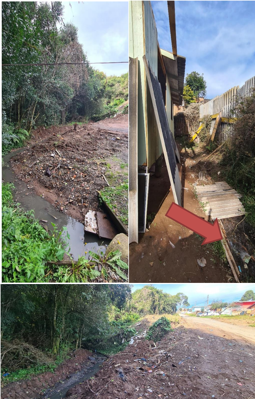
Figura 25 - Esgoto a céu aberto na lateral de uma das moradias
