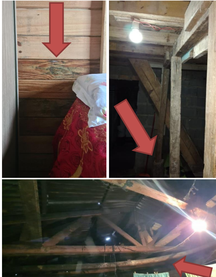
Figura 19 - Estrutura de sustentação da moradia danificada com a movimentação do solo
