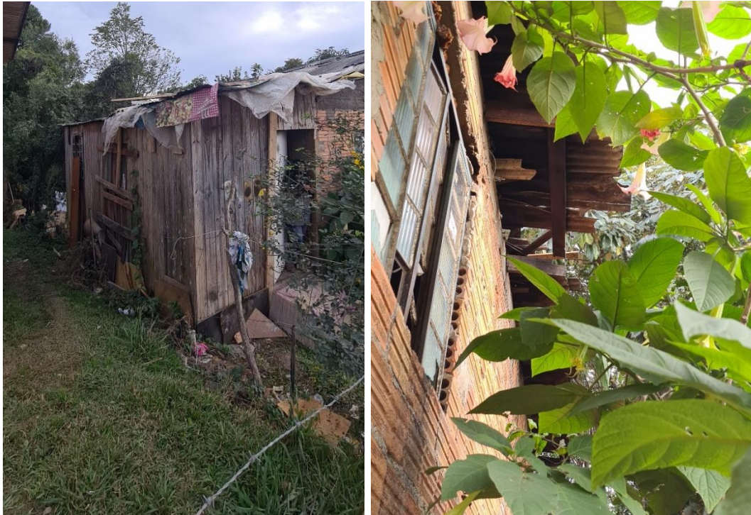
Figura 13 - Moradia com cobertura precária composta por telhas amianto quebradas e lonas
