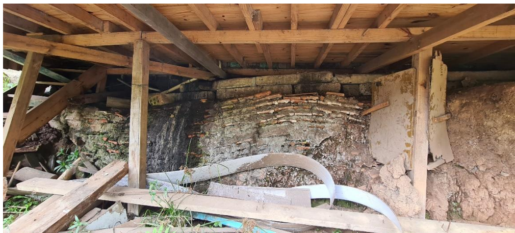
Figura 18 - Estrutura de sustentação da moradia danificada com a movimentação do solo
