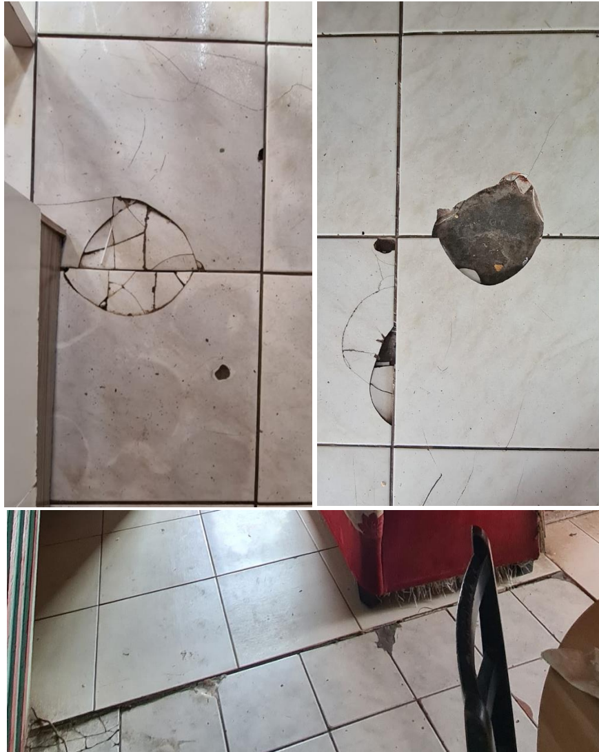
Figura 11 - Destacamento e quebra de pisos cerâmicos nas moradias
