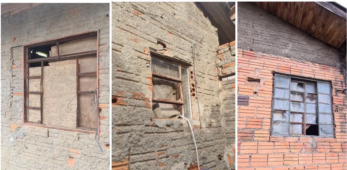
Figura 15 - Janelas das moradias com vidros quebrados ou sem vidros
