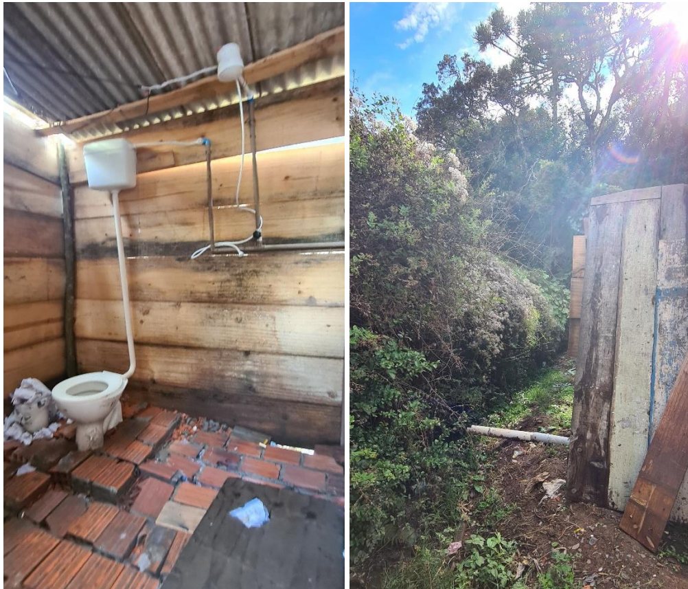
Figura 22 - Banheiro externo com vaso desembocando a céu aberto em péssimas condições
