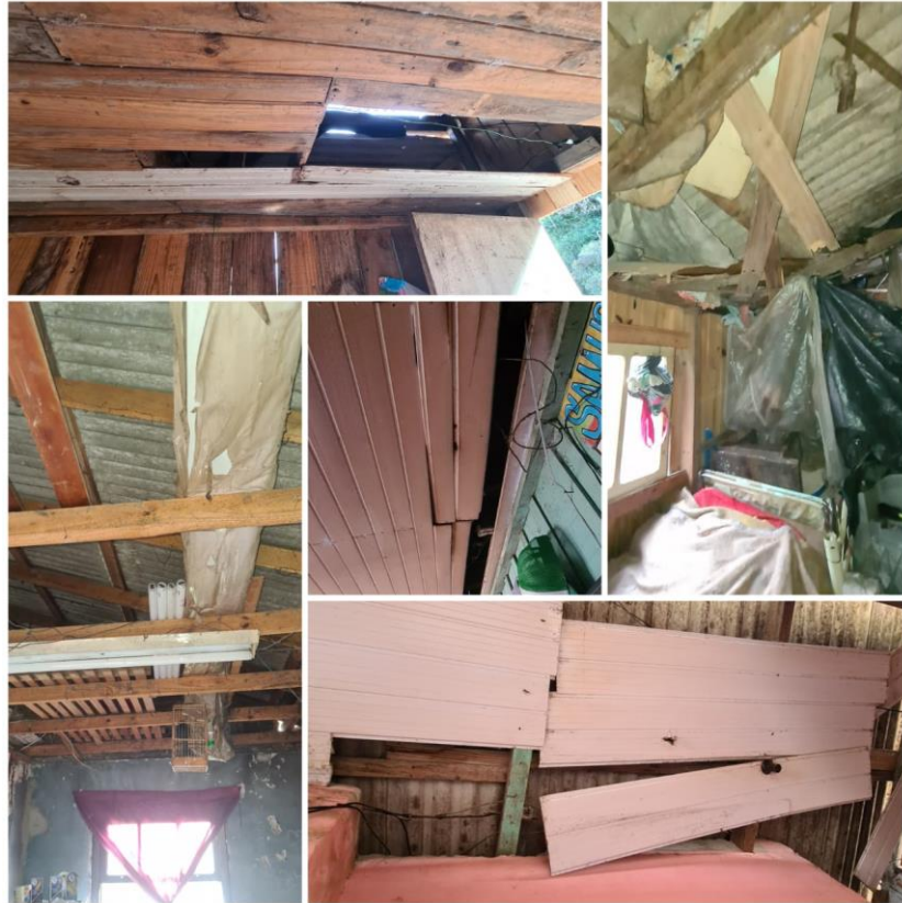
Figura 14 - A inexistência de forro e forros precários das moradias
