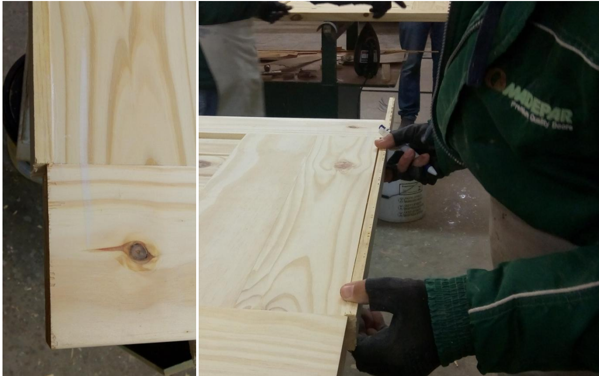
Figura 9: Batente e o montante, não foram feitos do mesmo tamanho.
