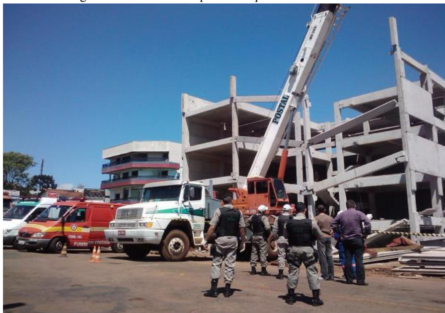
Figura 3 - Desabamento parcial de prédio em Erechim - RS
