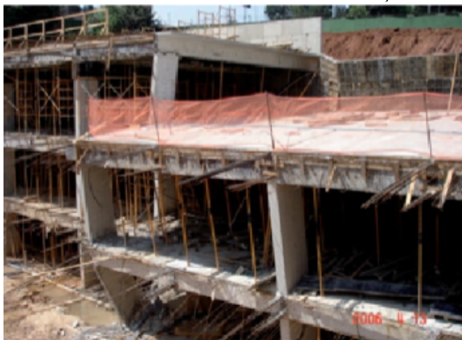
Figura 13 - Desmoronamento resultante da desconsideração dos empuxos
