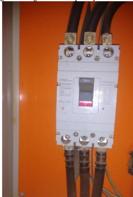
Figura 10: Regiões energizadas sem proteção contra choques elétricos.
