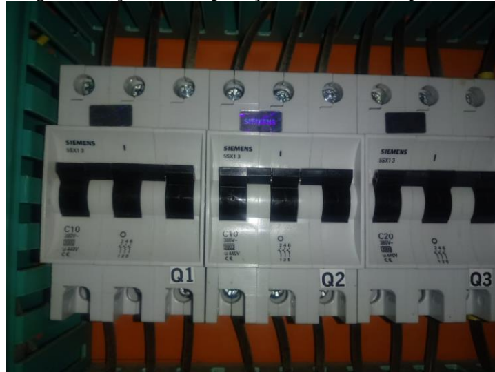
Figura 6: Disjuntores de proteção individual de capacitores.
