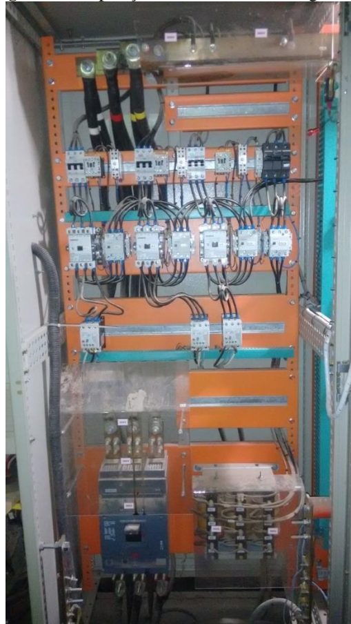
Figura 11: Exposição de barramentos energizados.
