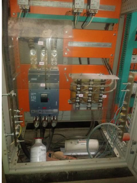
Figura 9: Material condutor elétrico inapropriado dentro do painel elétrico.
