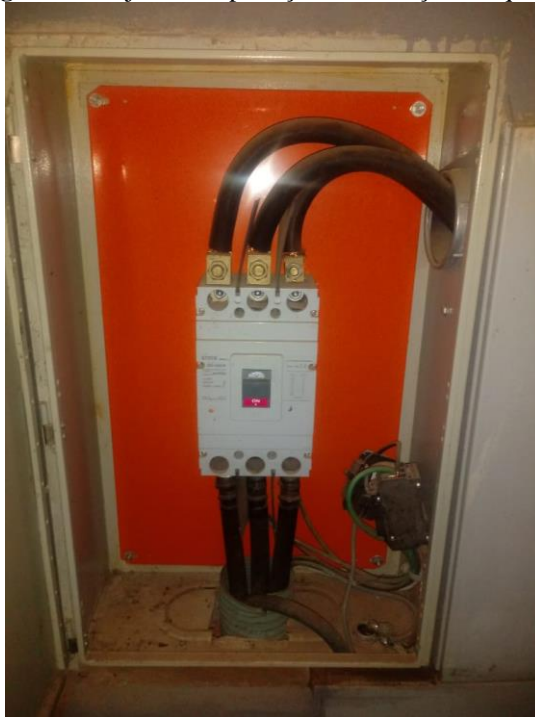
Figura 7: Disjuntor de proteção sem fixação adequada.
