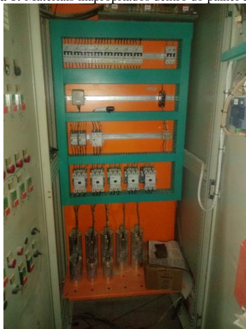
Figura 8: Materiais inapropriados dentro do painel elétrico.
