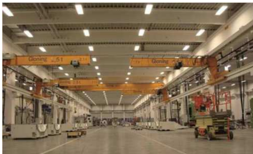
Figura 16- Uniformidade da Iluminação
