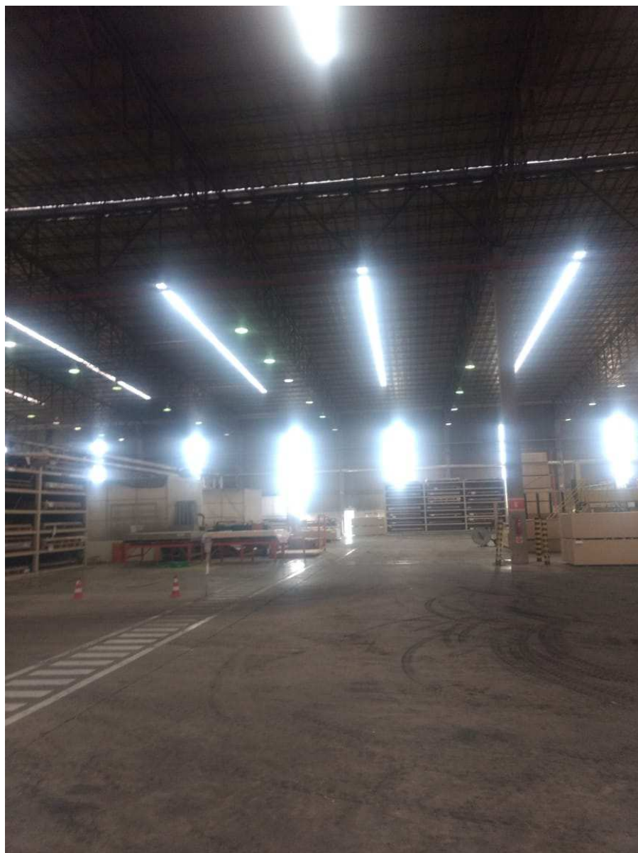
Figura 33- Iluminação interna área das Linhas de revestimento
