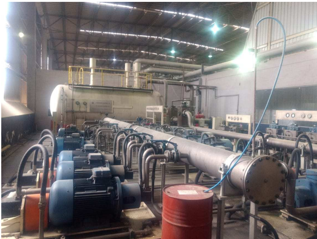
Figura 41- Motores Unidade Hidráulica
