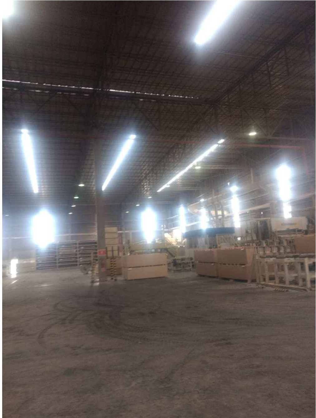
Figura 34- Iluminação interna área da Lixadeira
