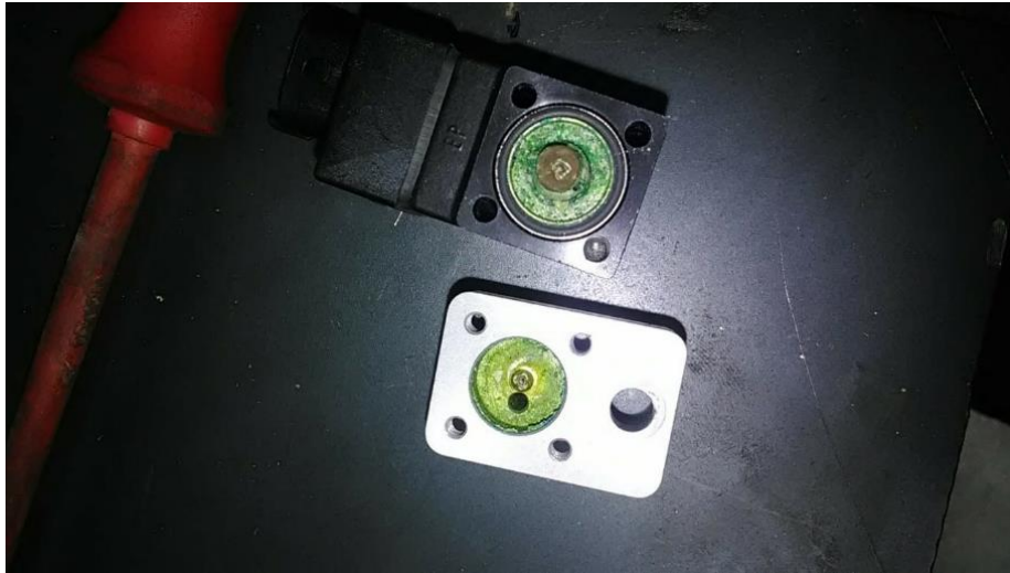
Figura 32: Eletroválvula – Controle de fluxo de ar, obstruída
