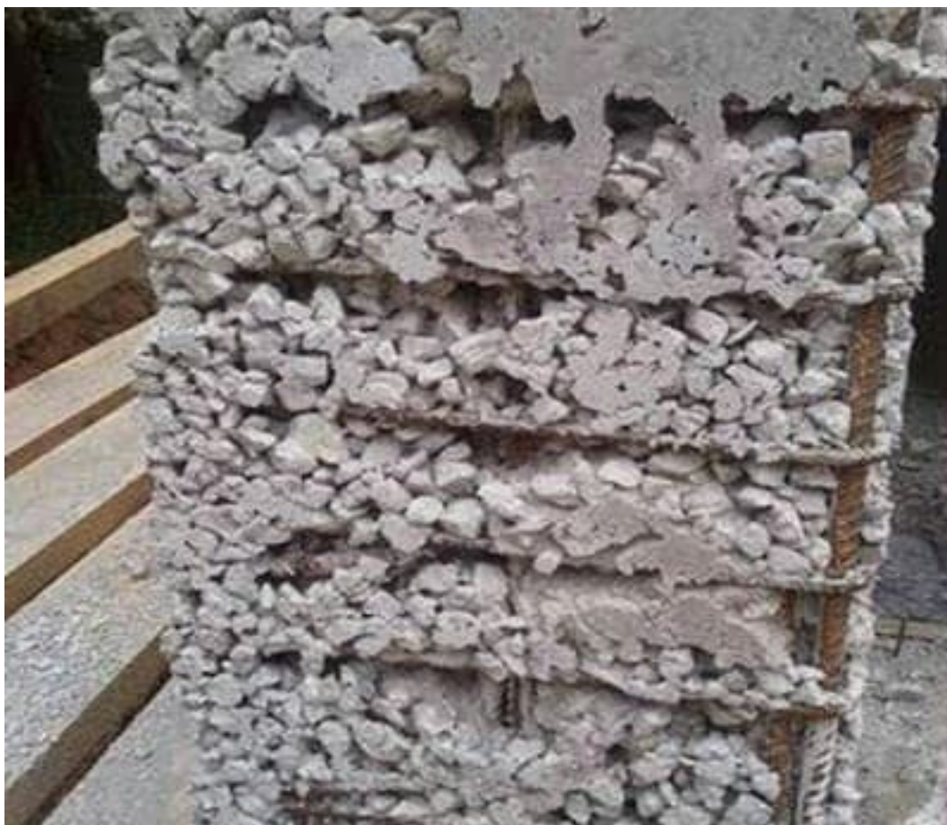
Figura 8 – Segregação em pilar de concreto armado
