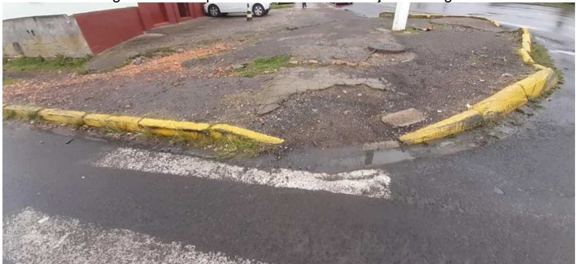
Figura 23 - rampa mal conservada e calçadas irregular
