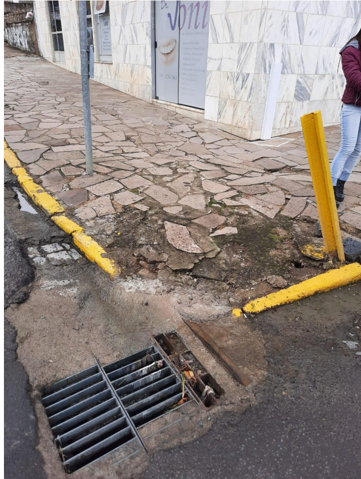
Figura 26 – Rampa com boca de lobo na decida, e em mal estado
