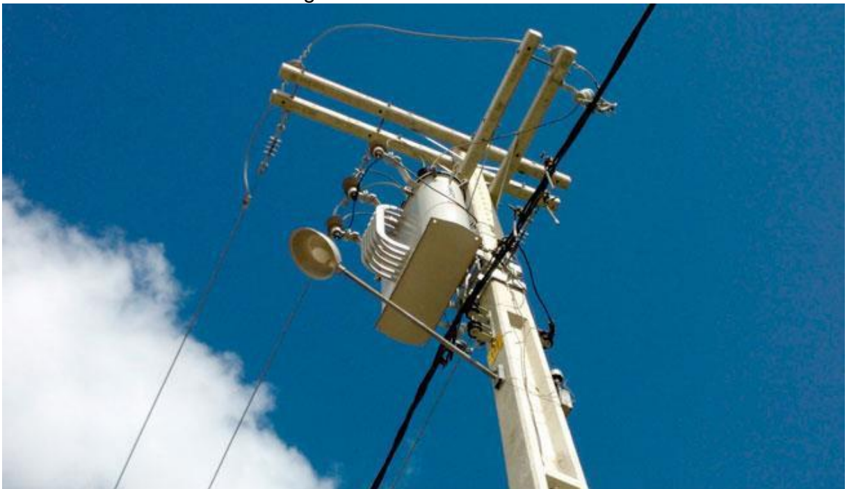
Figura 3: Transformador de tensão.
