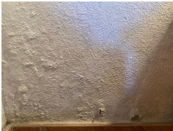
Figura 25 - Bolhas e desagregamento na parede do dormitório.
