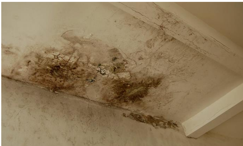
Figura 7 - Manchas decorrentes da umidade em laje.
