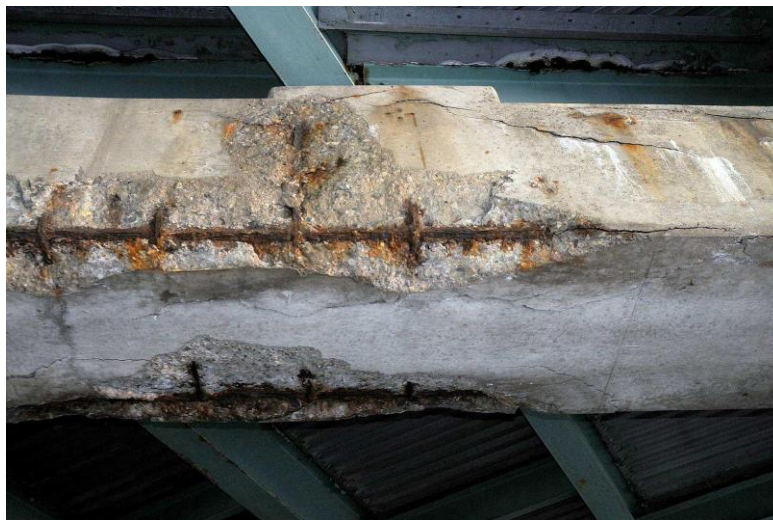
Figura 4 - Carbonatação em viga de concreto e corrosão da armadura.
