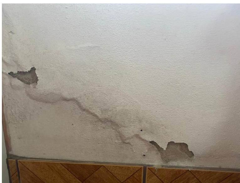
Figura 8 - Paredes com bolhas e desagregamento do reboco.
