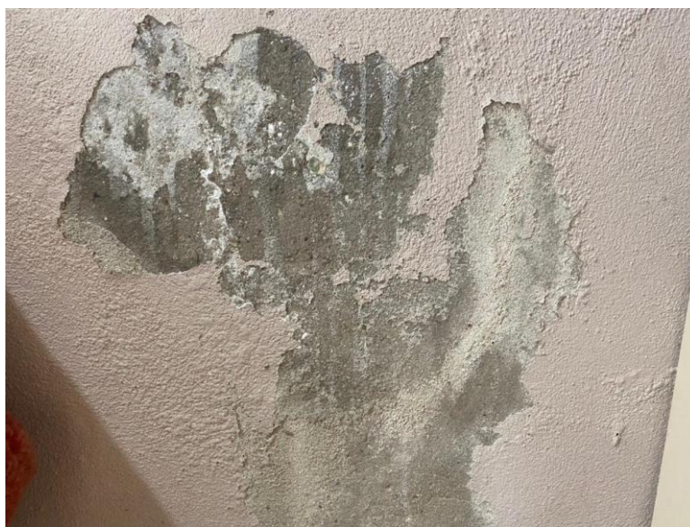
Figura 24 - Eflorescência presente na parede da garagem da edificação.
