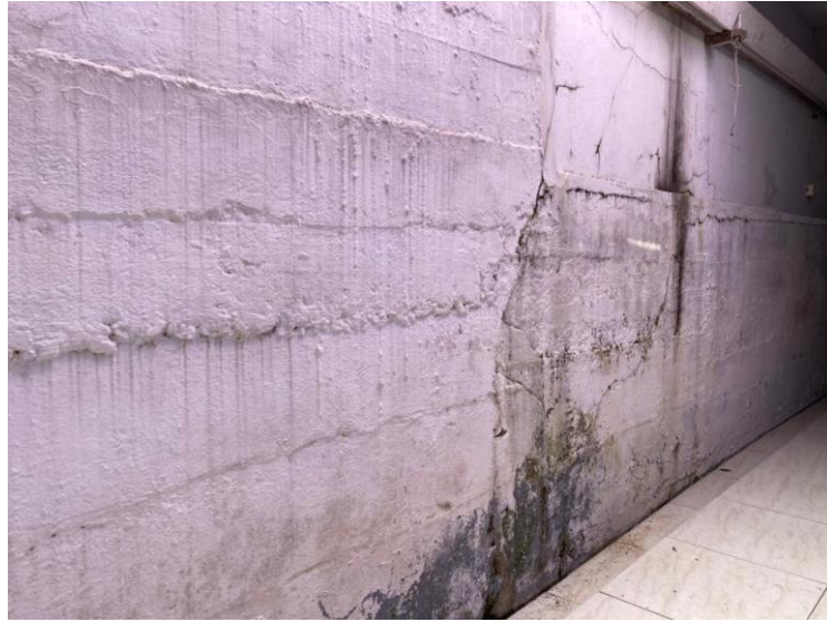
Figura 32 - Muro de arrimo com patologias.
