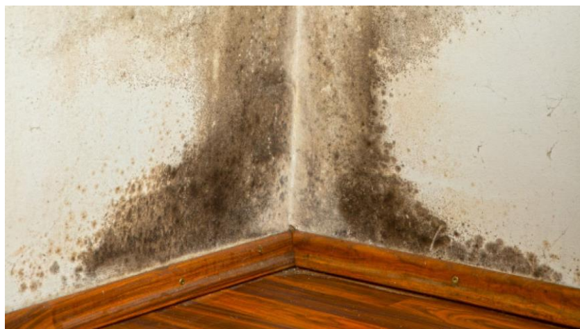
Figura 6 - Mancha de mofo em parede alvenaria.
