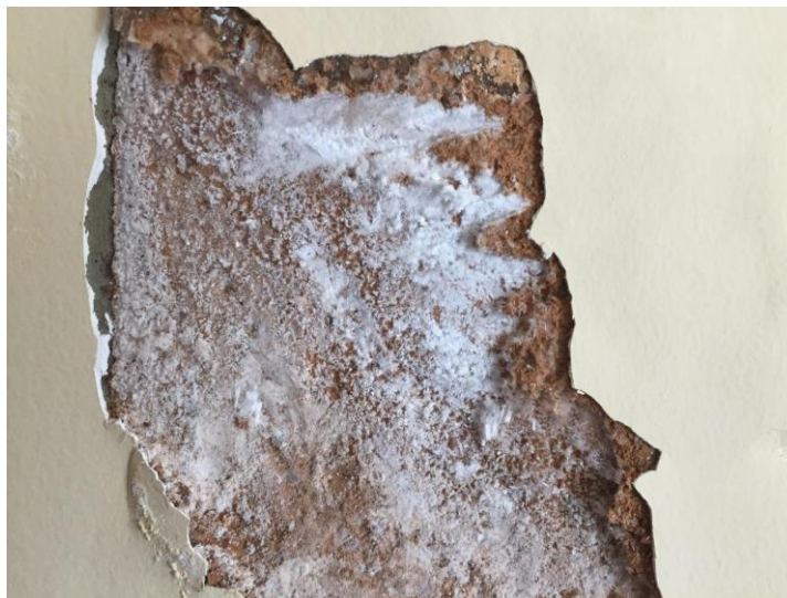
Figura 3 - Criptoflorescência em parede de alvenaria.
