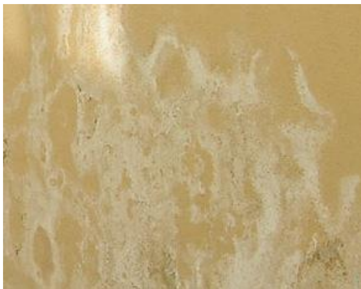
Figura 9 - Parede com eflorescência.
