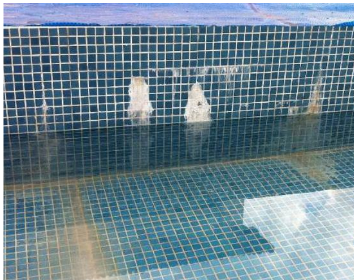
Figura 2 – Eflorescência em piscina.
