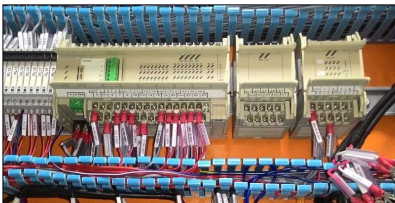
Figura 10 - Bornes do CLP substituído
