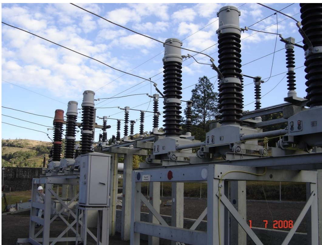
Figura 60 - Transformador de Potencial e Corrente, Usina Celso Ramos, Faxinal dos Guedes SC.
