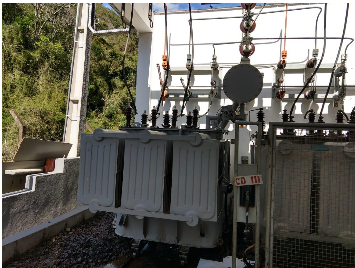
Figura 18 - Transformador Elevador 1500 MVA, Usina Ivo Silveira, Campos Novos SC.
