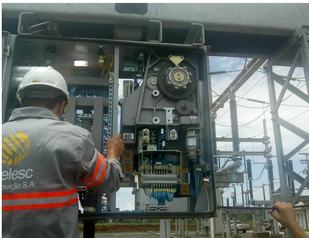
Figura 58 – Disjuntor Siemens 145 kV, Usina Pery, Curitiba SC.
