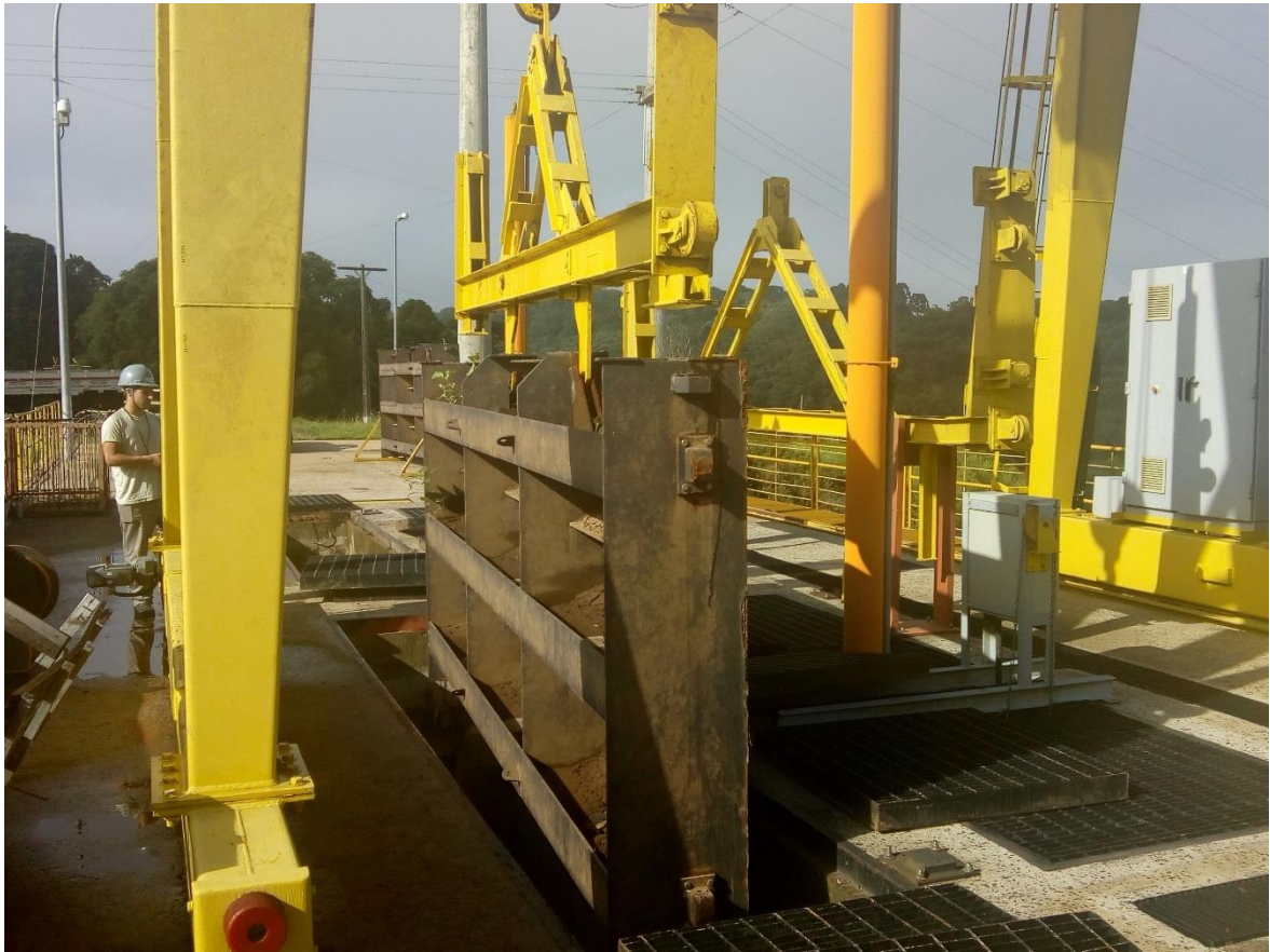
Figura 37 – Comporta de Ensecadeira (Manutenção) Usina Pery, Curitibaanos SC.
