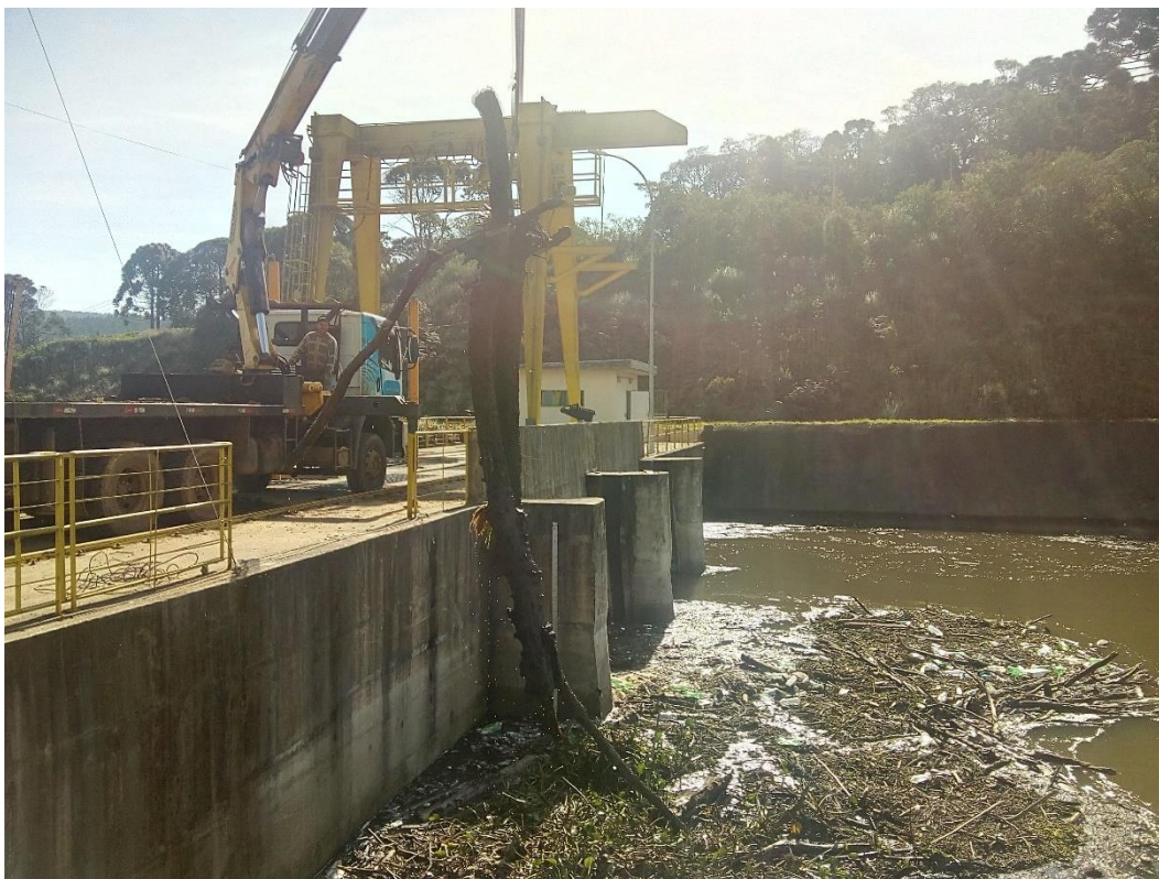
Figura 13 - Perca de carga devido á sujeira na entrada do conduto forçado, Usina Pery, Curitibaanos SC.
