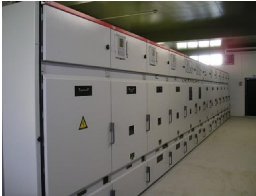
Figura 52 – Cubículos de Média Tensão.
