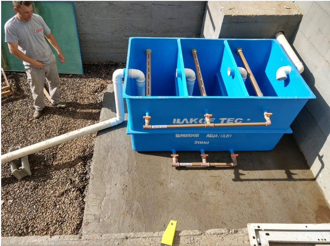
Figura 50 – Sistema de separação água e óleo, Usina Pery, Curitiba/SC.
