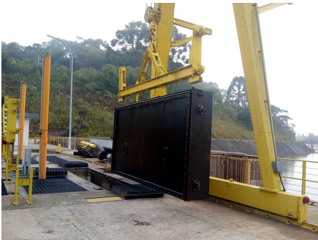
Figura 42 – Pórtico Rolante, Tomada de água usina Pery, Curitibaanos SC.
