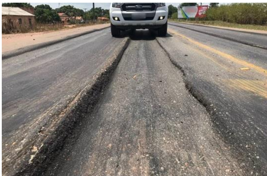
Figura 14 – Pavimento com dano por ruptura funcional
