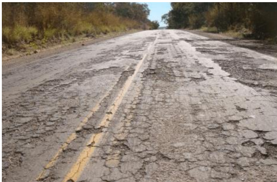
Figura 13 – Pavimento com dano por ruptura estrutural
