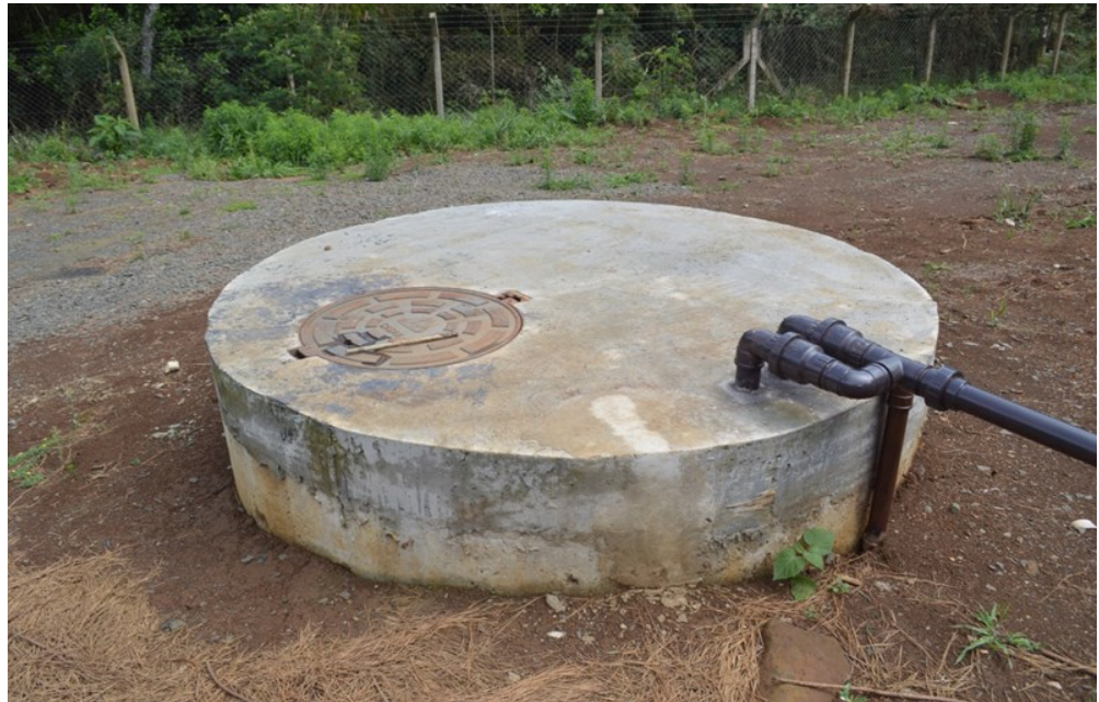
Figura 3–Sistema de Gradeamento Ponto 1 efluente bruto, Universidade Federal de Santa Catarina em Curitibanos/SC.
