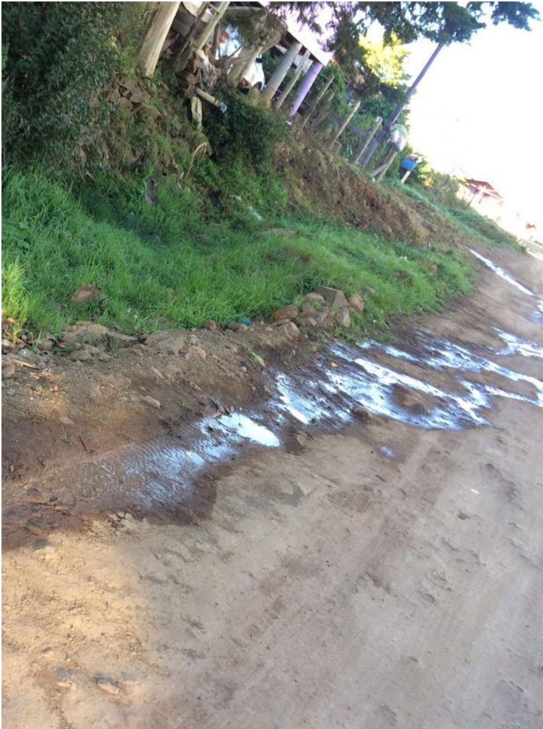
Figura 05 - PROBLEMAS DE ESCOAMENTO
