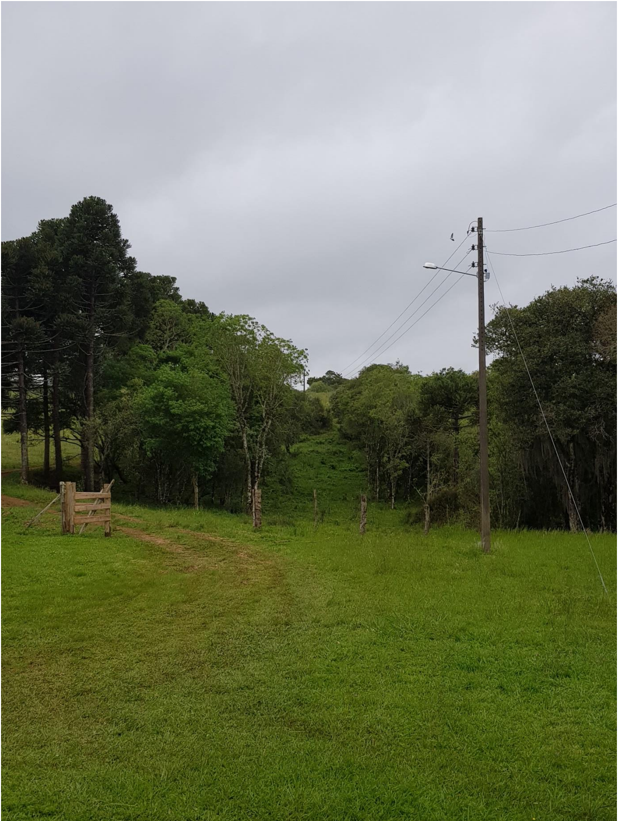
Figura 28 - Imagem de uma rede de distribuição da área pesquisada.
