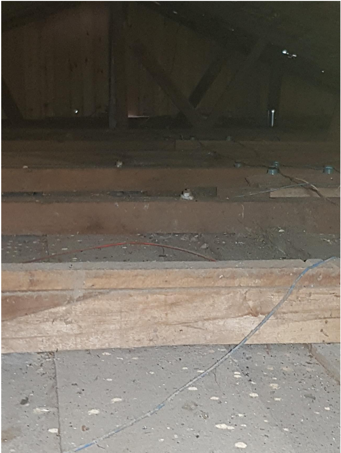
Figura 30 - Imagem de uma instalação elétrica com mais de 10 anos.
