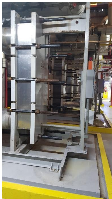
Figura 5 - Trocadores de Calor
