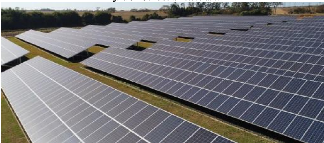
Figura 6 – Usina solar fotovoltaica.
