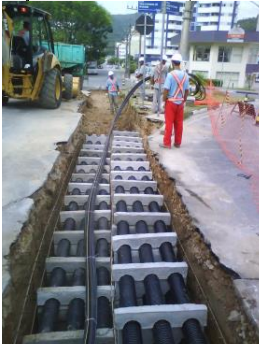
Figura 11 – Banco de dutos em rede de distribuição subterrânea.
