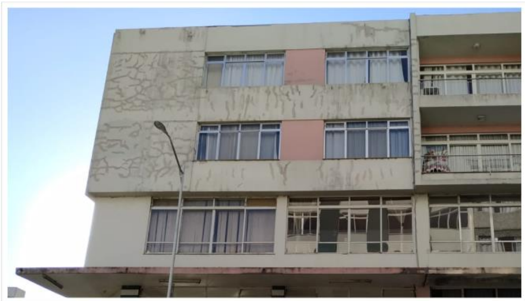
Figura 6: Edificação predial com patologia aparente.
