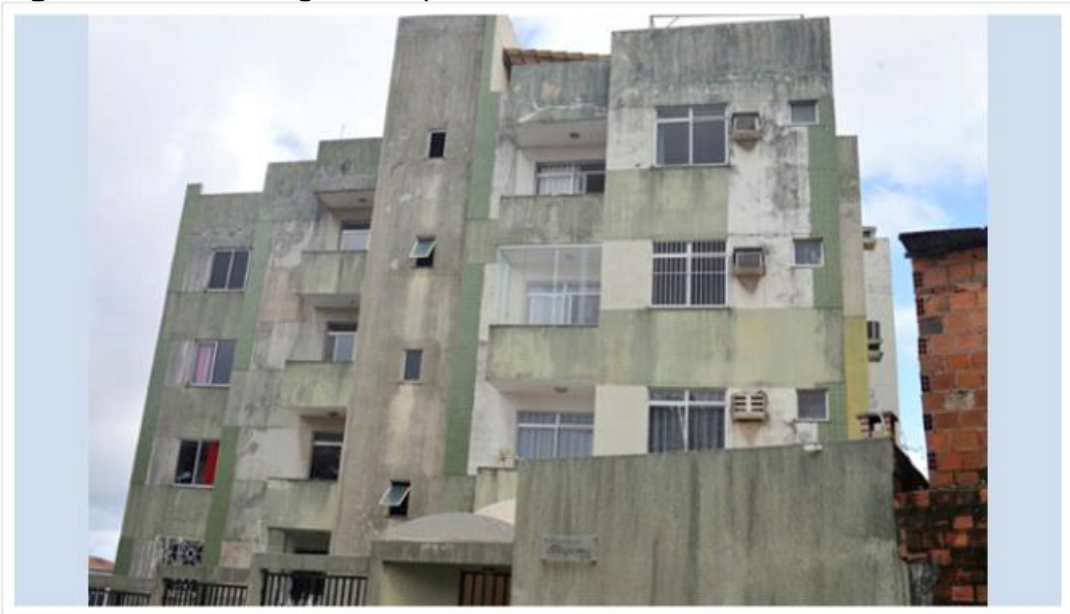
Figura 9 – Prédio degradado por umidade.
