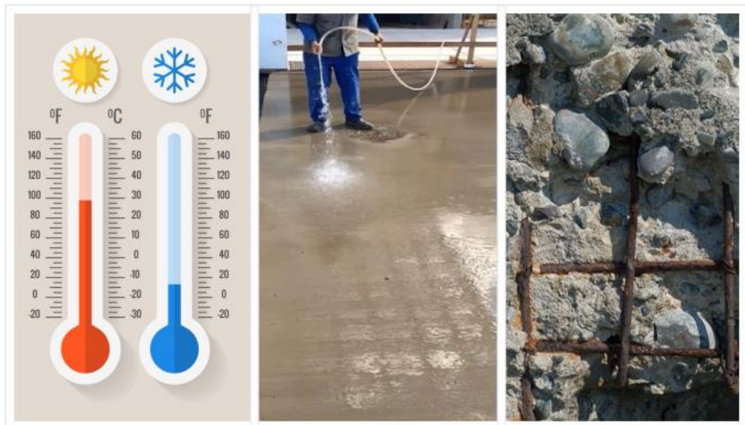
Figura 1 – Diferença de temperatura, reação química do concreto e corrosão.
