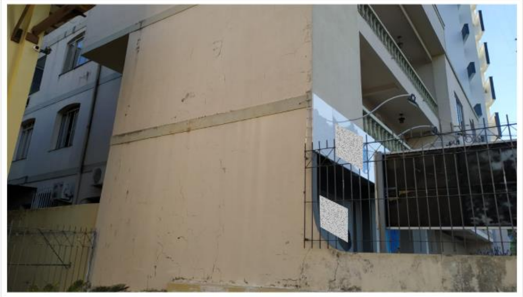
Figura 19 – Fissuras em edificação predial
