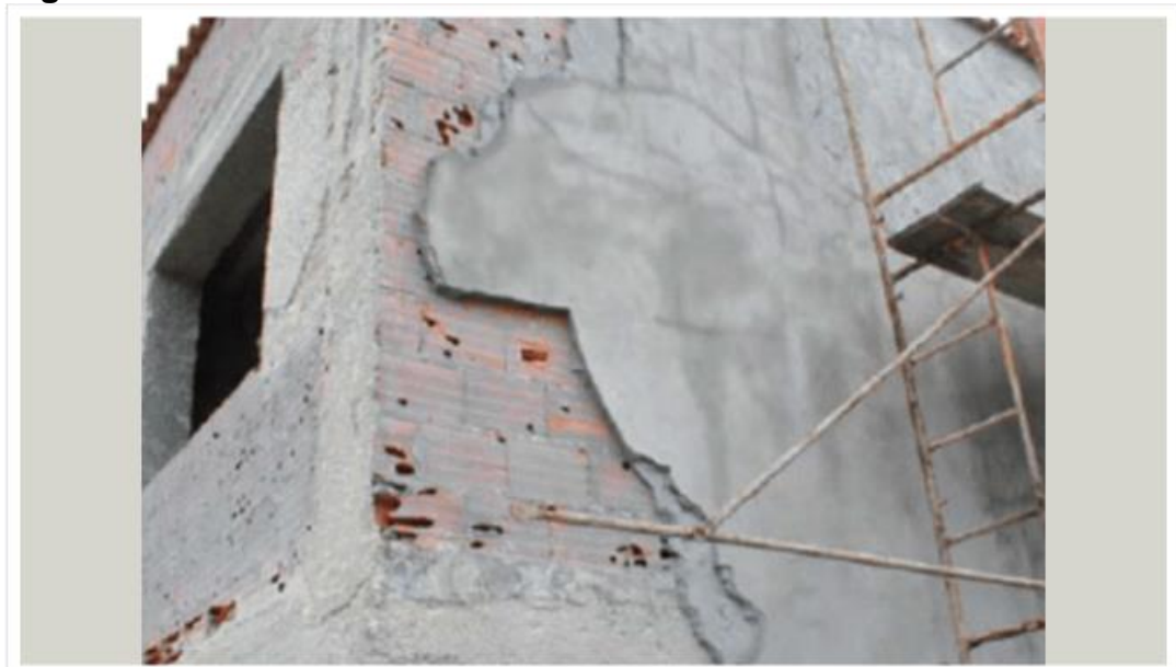
Figura 13 – Destacamento do reboco.
