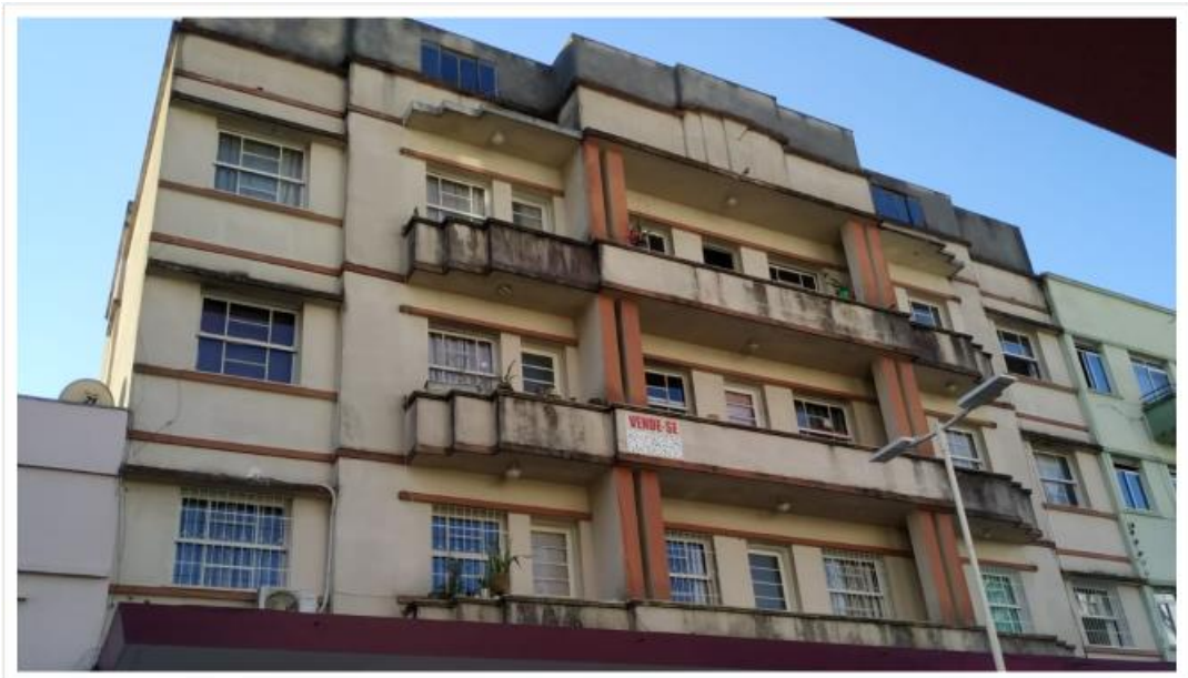
Figura 10 – Atuação da umidade em edificação predial.
