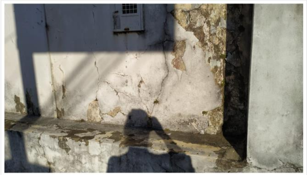
Figura 5: Degradação e patologias por decorrência de umidade.
