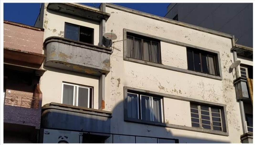
Figura 15 – Edificação predial com indícios de destacamento.
