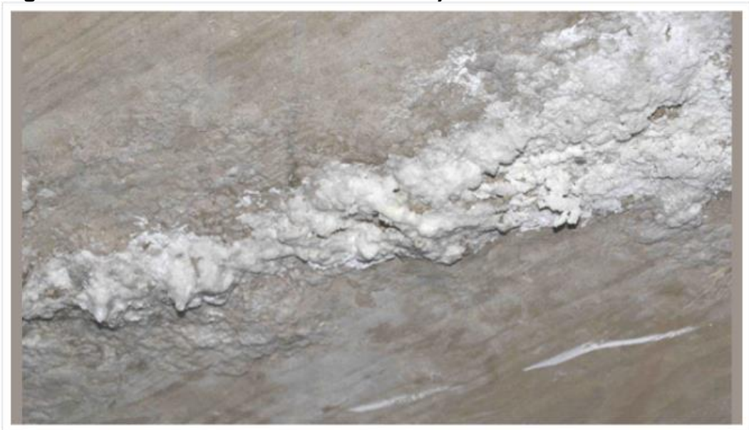
Figura 12 – Mancha de eflorescência na laje de concreto.
