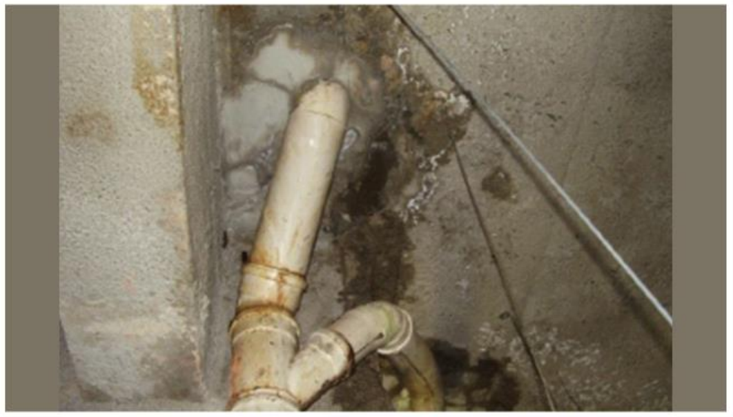
Figura 11 – Mofo ocorrido devido a vazamento do ralo.
