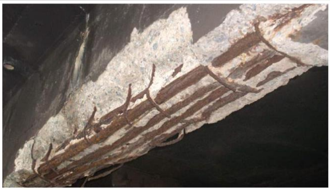
Figura 20 – Viga com armadura corroída.
