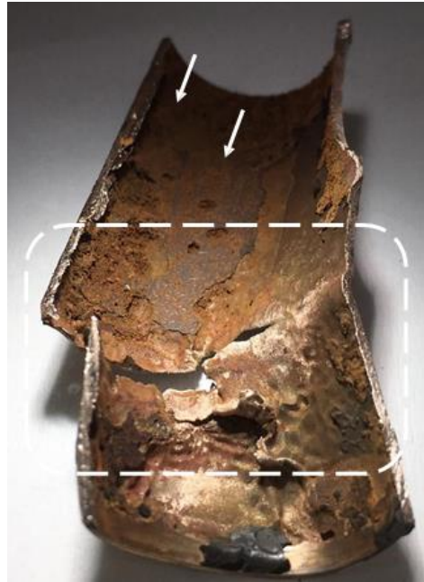
Figura 11 Entrada do tubo que apresentou defeito.
