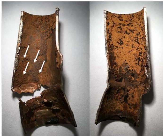
Figura 10 Seção longitudinal no trecho inicial (próximo ao espelho) do tubo com defeito.
