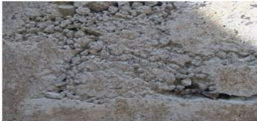
Figura 27 – Segregação e nichos de concretagem causadas, principalmente, por falhas na execução do concreto.
