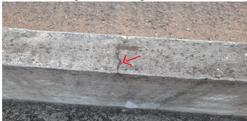
Figura 42 – Fissura no guarda-rodas
