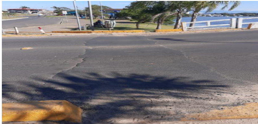
Figura 40 – Deformação do pavimento
