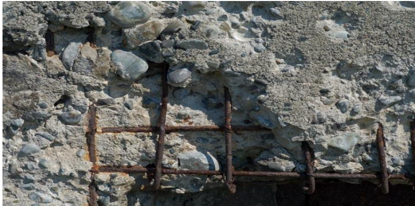
Figura 26 – Carbonatação em concreto armado
