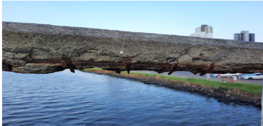
Figura 39 – Deterioração do guarda-corpo por corrosão
