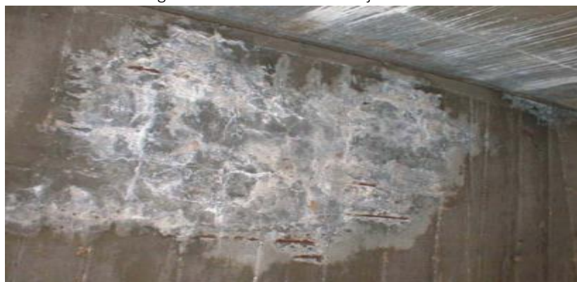
Figura 21 – Face inferior da laje: Eflorescência
