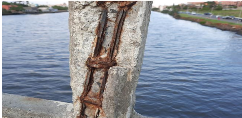
Figura 38 – Armadura exposta e concreto deslocado
