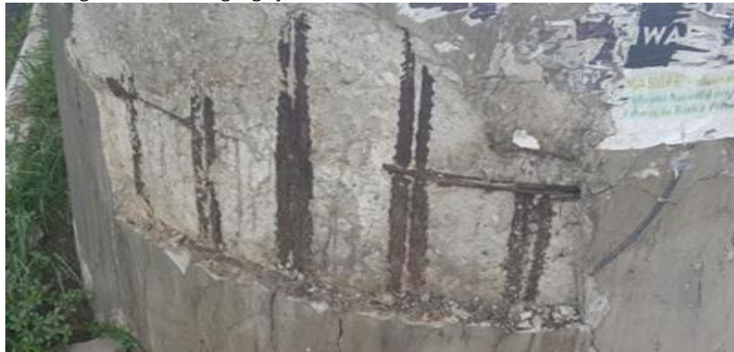
Figura 23 – Desagregação do concreto e corrosão das Armaduras
