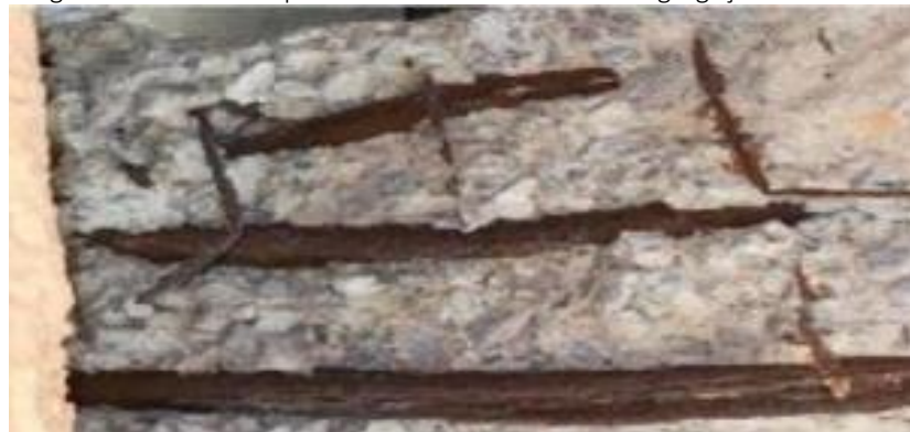
Figura 24 – Partes da ponte Princesa Isabel com Desagregação do concreto
