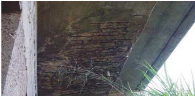
Figura 29 – Face inferior em balanço sem pingadeira: Degradação do concreto, perda de cobrimento e armadura exposta e corroída
