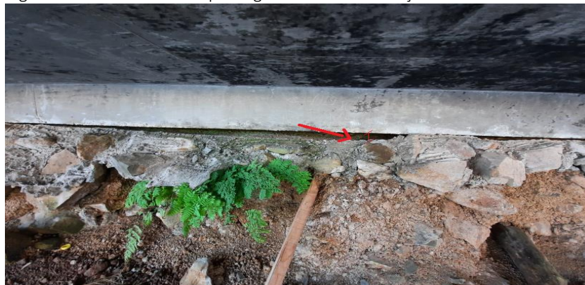
Figura 47 – Erosão do solo pedregulhoso sob a fundação de um dos encontros
