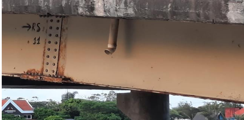
Figura 41 – Manchas de umidade na laje em balanço e Rebites
