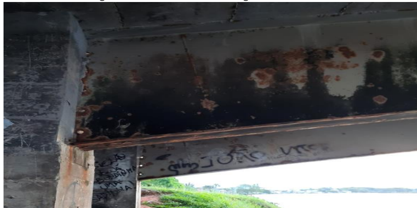
Figura 44 – Corrosão das longarinas metálicas
