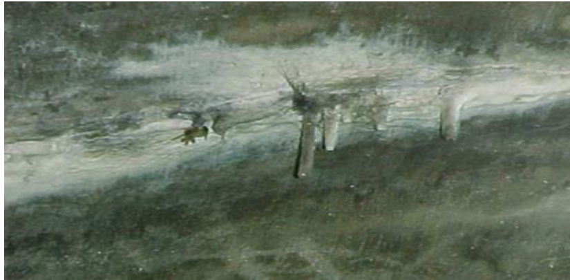
Figura 22 – Patologia nos encontros: Eflorescência em pare frontal
