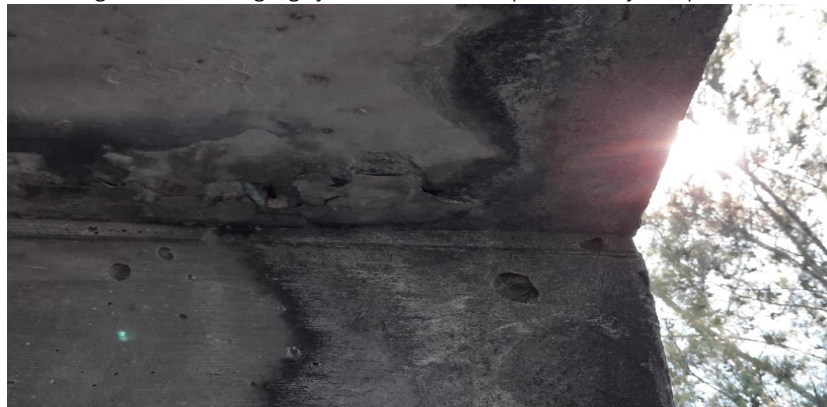
Figura 48 – Desagregação e armadura exposta na laje do passeio
