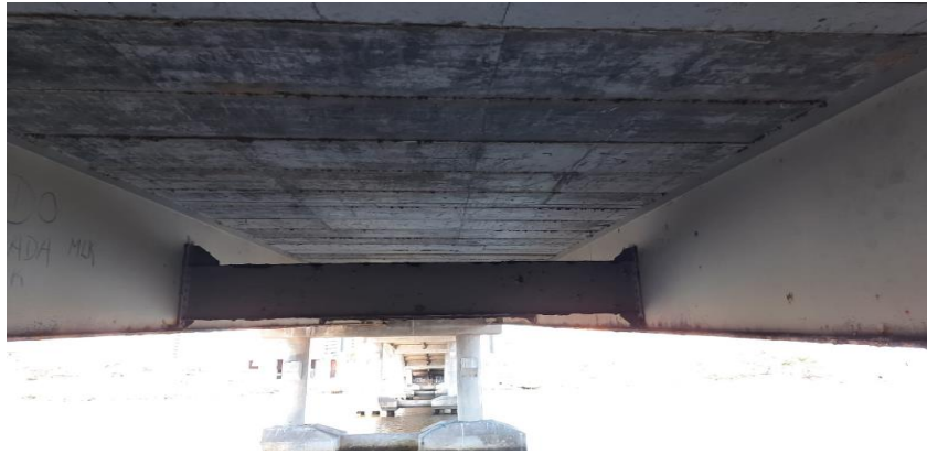
Figura 43 – Vista inferior das lajes com Corrosão das transversinas metálicas
