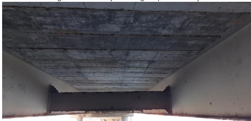
Figura 45 – Lixiviação em alguns pontos da laje
